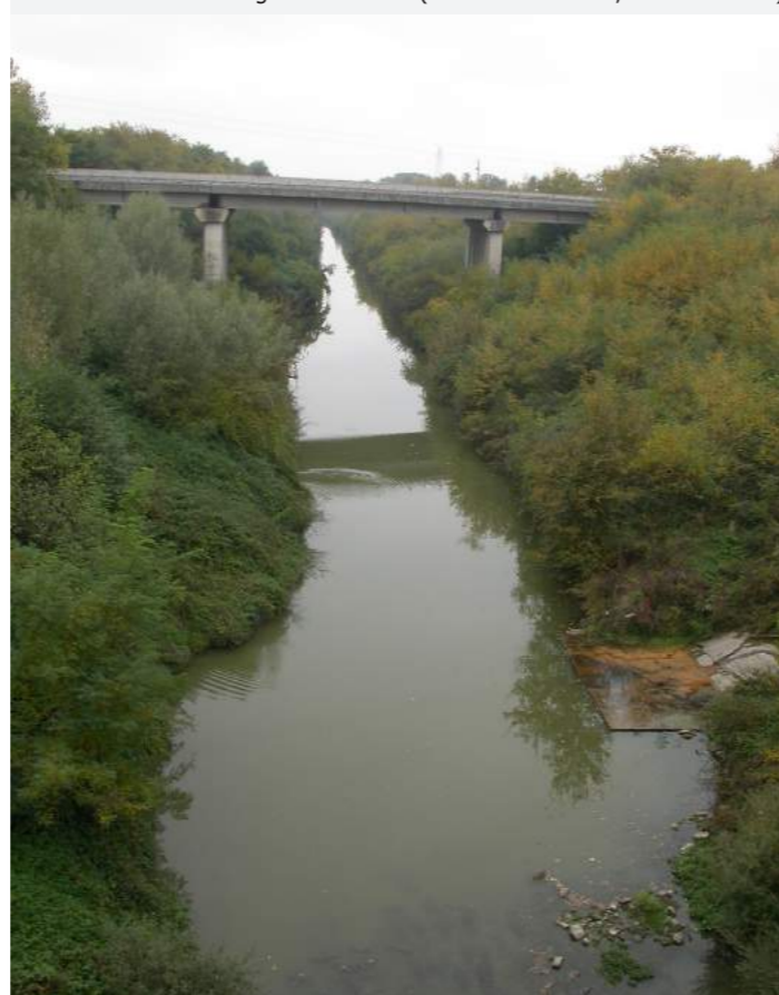
Canale Maestro della Chiana in loc. ponte della SS 73 (Pieve al Toppo) con sponde interessate da vegetazione antropofila di degradazione a rovi e robinia e con isolate specie arboree igrofile (foto L. Lombardi, archivio NEMO)
