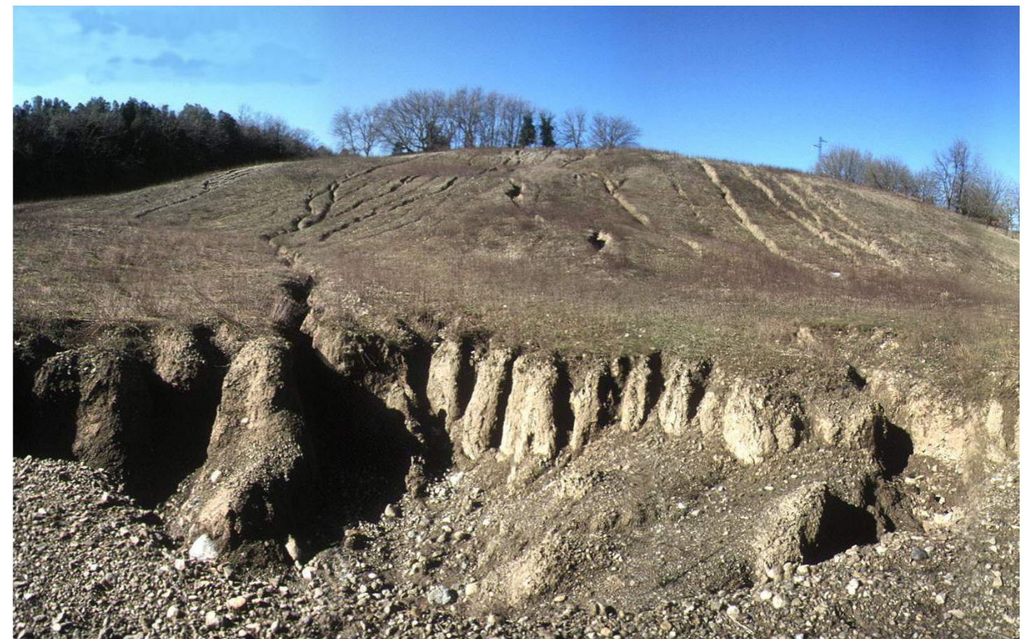
Versante in erosione lungo il Fosso Rigo (Foto Archivio Geositi Provincia di Siena)
